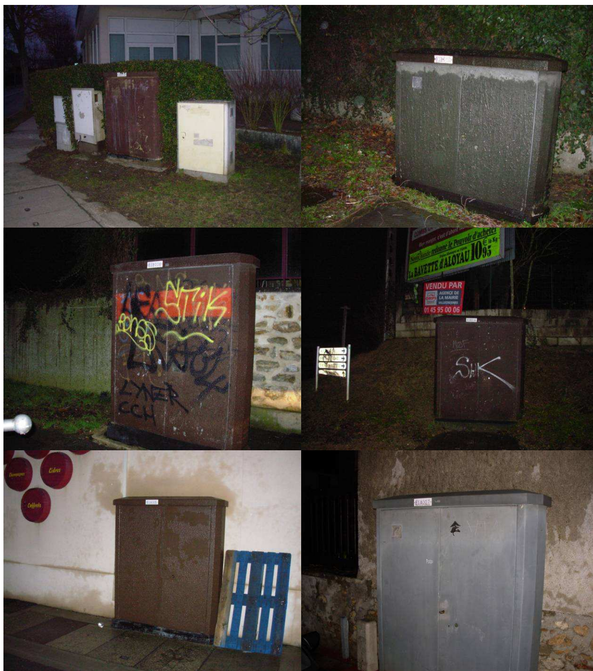
Photographies prises sur site des sous-répartiteurs SAN015, BSB010, BSB008, BSB016, BSA 005, BSA007
