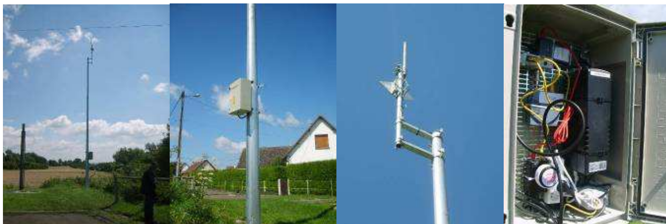
Photographies d'une station de base WiFi 5,4 GHz, installée sur un mât de 12 m
